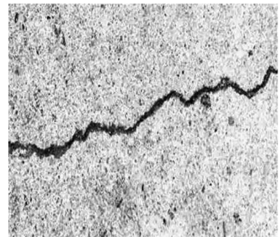
图3 二值化处理后的裂缝图像
