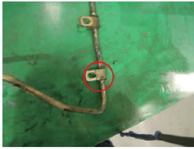
图1 高压油管管夹断裂
